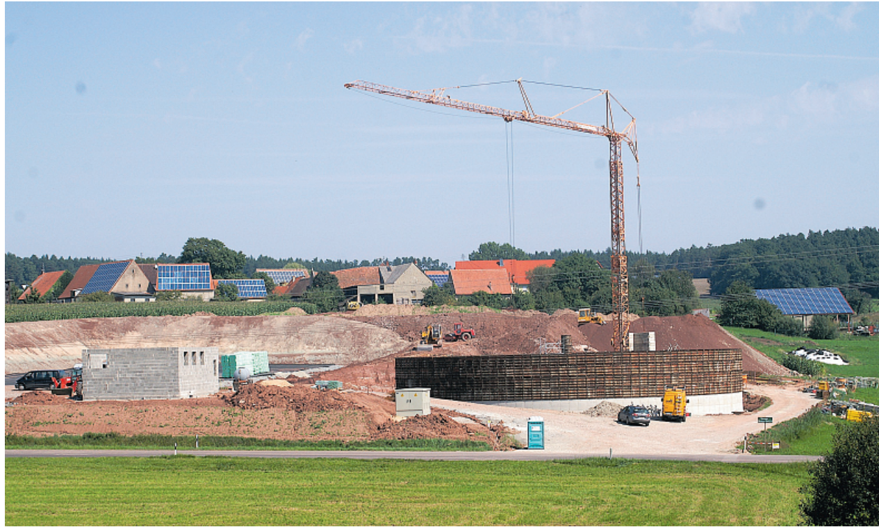
Alles genehmigt: Spätestens zum Jahreswechsel soll die Anlage fertig sein und rund 380 kW Strom ins Netz einspeisen.
